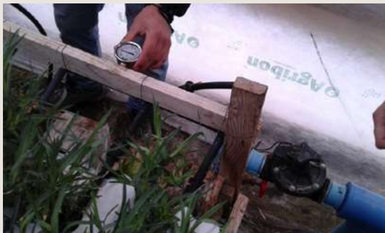
Foto 2: Uso de manómetro para control del funcionamiento del equipo de riego en entrada de sector de riego para esquejes de clavel.
